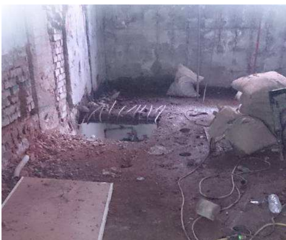
▲ 2 公尺以上開口未設護欄、護蓋，及電線置於潮濕場所未架高等防護。
