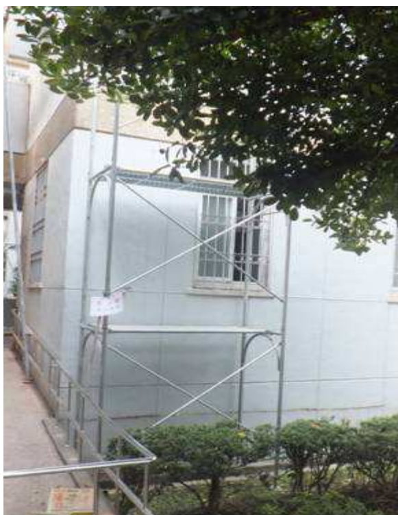
▲ 不合格之施工架
