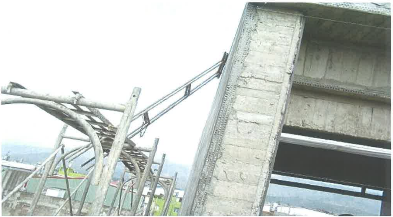
5. 將移動梯、合梯置於施工架上使用，有墜落之虞不符合規定之照片。
